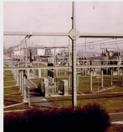
UW (Umspannwerk) Erlangen Mitte 110-kV-Freiluftschaltanlage
