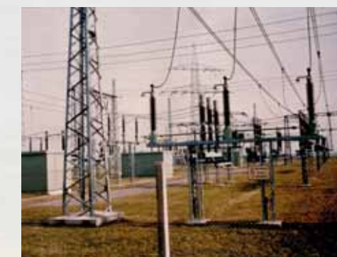
UW Kastenweiher 110-kV-Freiluftschaltanlage
